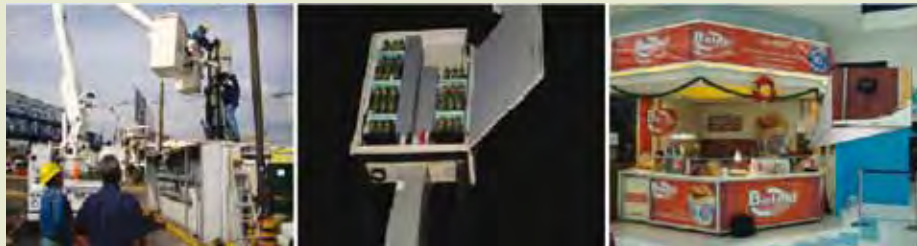
Instalación del SIM-IV en un centro comercial del Estado de Morelos.
